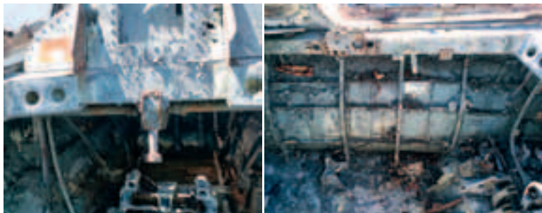
■ INWENTARYZACJA USZKODZEŃ I BRAKÓW
